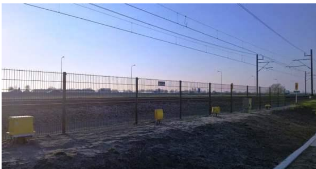
Figure 85 : Ligne de Hanzelijn avec les équipements en bord de voie Source : ProRail
