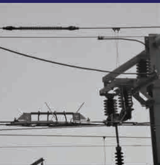
Isolateurs de Section_
